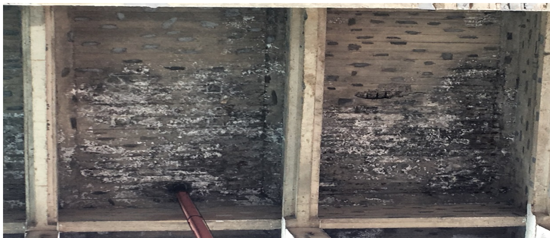
Рис. 2. Коррозионный процесс железобетонной плиты проезжей части.
