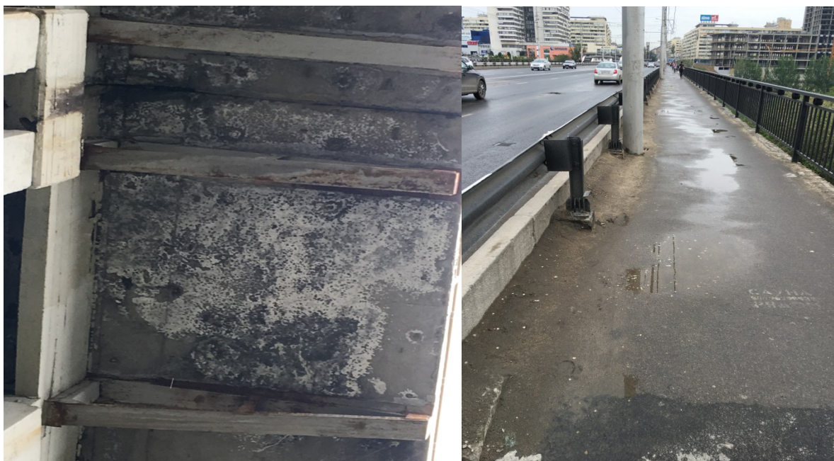
Рис. 1. а) выщелачивание бетона тротуарной консоли моста в местах застоя воды, б) скопление воды на тротуаре моста в Волгограде.
