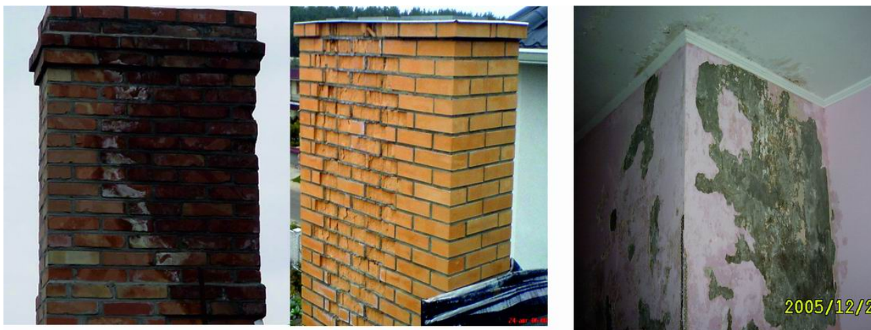
Рис 1. Разрушения дымоходов под действием конденсата
