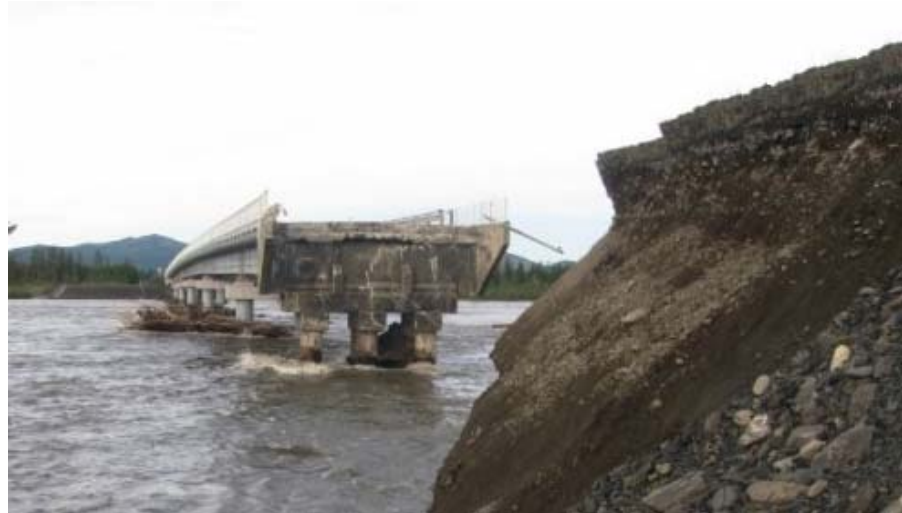
Рис. 3. – Размытие насыпи подхода к мосту в Якутии
