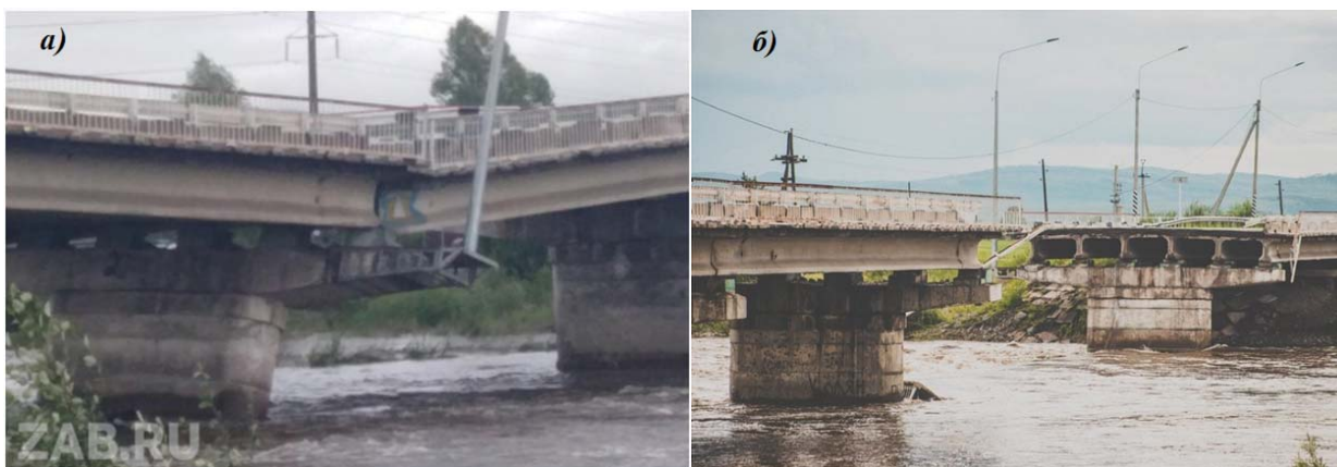
Рис. 1. – Разрушение Каштакского моста: а - крен опоры, б – обрушение пролета.
