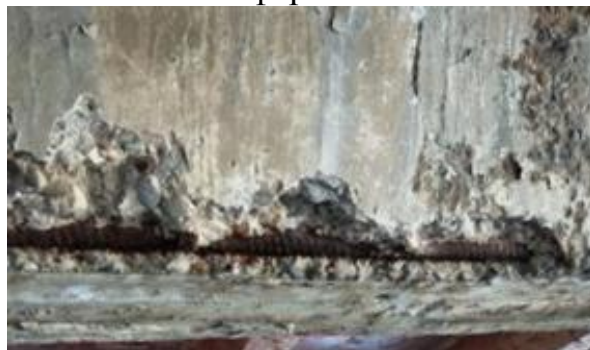
Рис. 4. – Повреждения в растянутой зоне ригелей перекрытия
