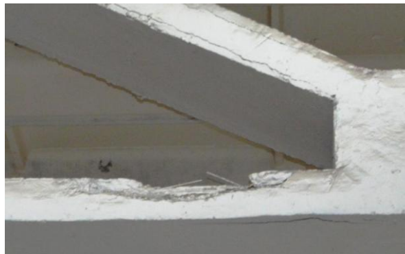
Рис. 2. – Повреждения в подкосе и растянутом поясе подстропильной фермы
