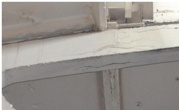
Рис. 1. – Продольные трещины в сжатом поясе стропильной фермы
