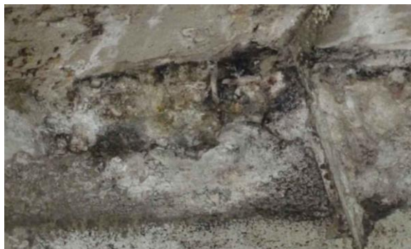
Рис. 3. – Дефекты в растянутой зоне балки
