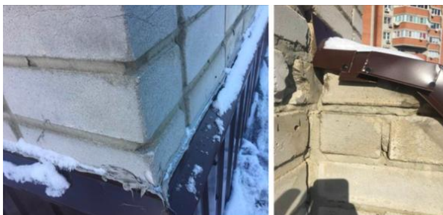
Рис.6. Нарушение герметизации стыка парапетных плит.
