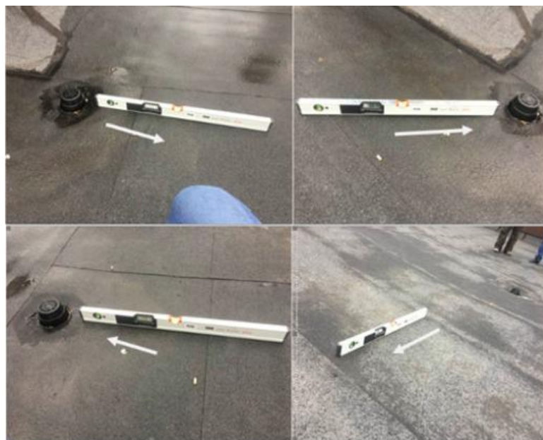
Рис.3 Нарушение уклона кровли
