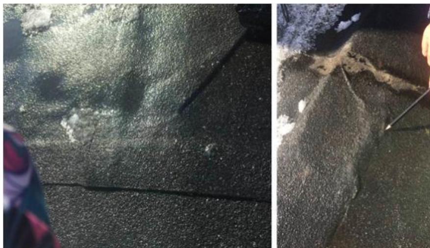
Рис.5 Складки и вздутия кровельного полотна.
