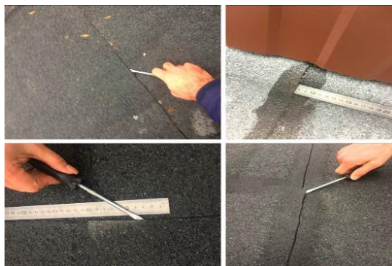
Рис. 4. Нарушение герметизации стыков кровельного полотна.
