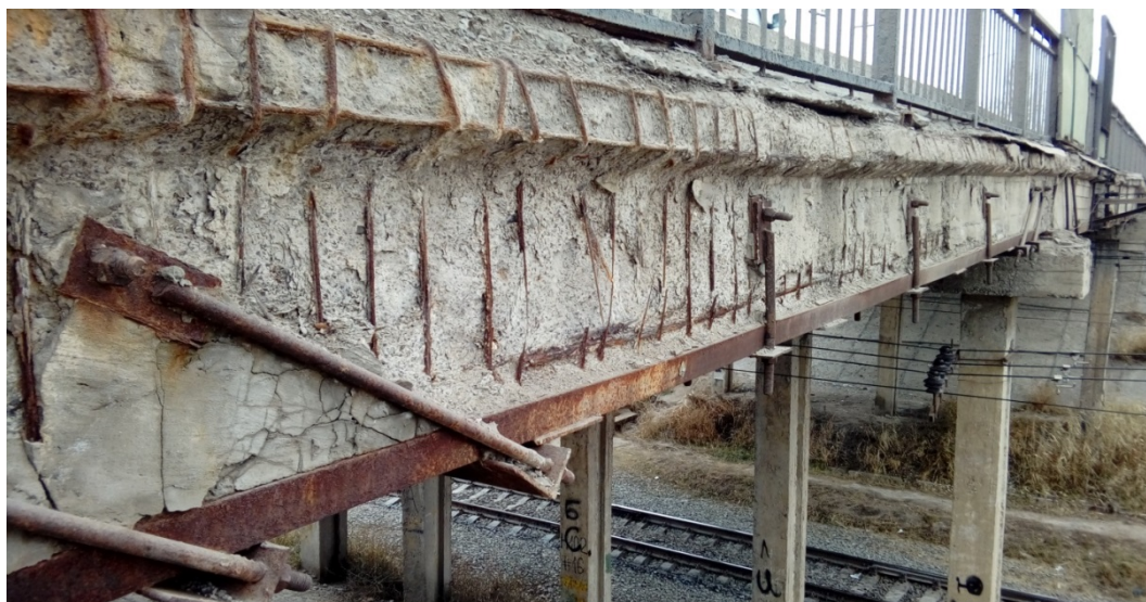
Рис. 1. Разрушение защитного слоя бетона и коррозия арматуры
